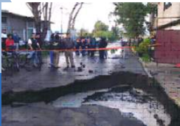
FOTOGRAFÍA 5.4.2 GRIETAS EN LA LOCALIDAD DE TLÁHUAC, 2005
