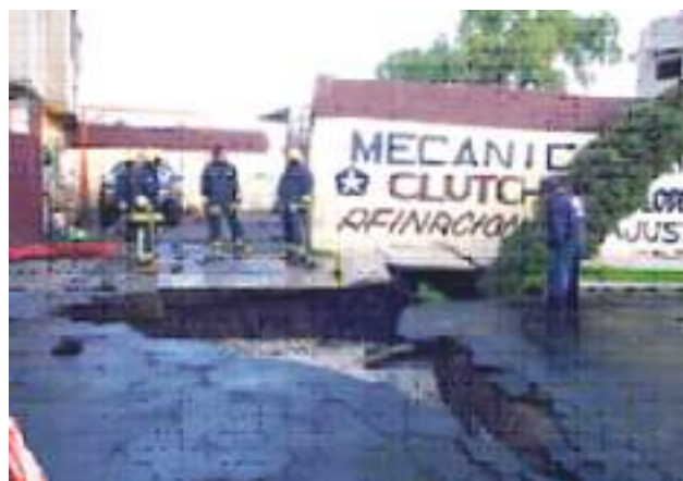
FOTOGRAFÍA 5.4.1 GRIETAS EN LA LOCALIDAD DE TLÁHUAC, AÑO 2005
