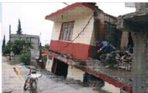
FOTOGRAFÍA 5.5. HUNDIMIENTO DE CASA-HABITACIÓN EN CHALCO, AÑO 2006
