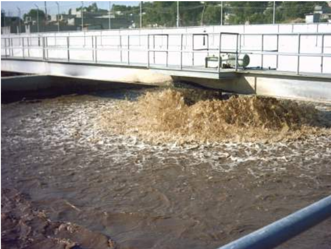
FOTO 5.6 PLANTA DE TRATAMIENTO EN 4 VIENTOS
