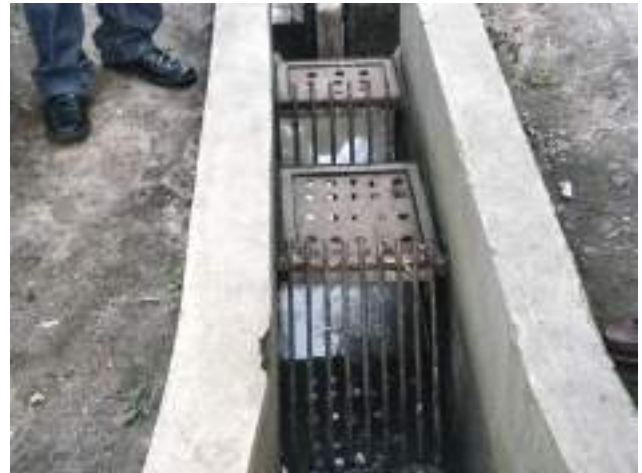
FOTOGRAFÍA 3.4 CRIBADO DE LAS AGUAS RESIDUALES.
