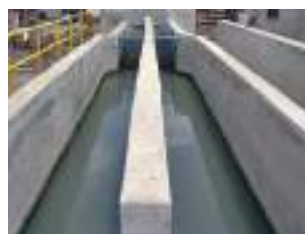
Campanas y canaletas de reboso de un reactor anaerobio UASB
